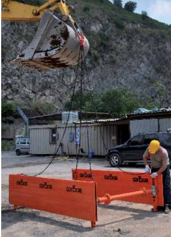
Tiro in alto con l'uso dell'escavatore Lifting using the excavator Tirage vers le haut avec l'utilisation de l'excavateur
